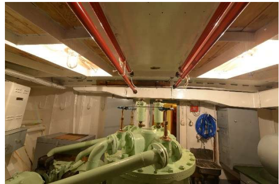
Figur 85 Fra rommet for styremaskin.. Rom 156
