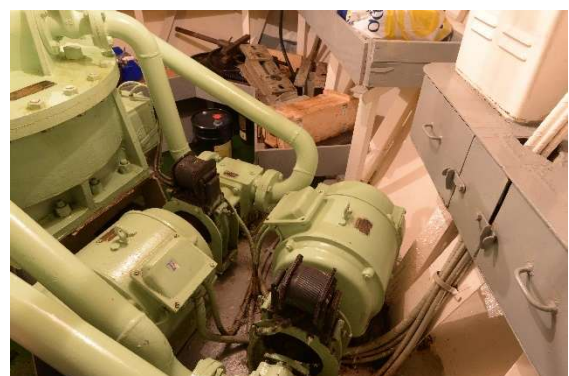
Figur 88 Fra rommet for styremaskin.. Rom nummer 156.
