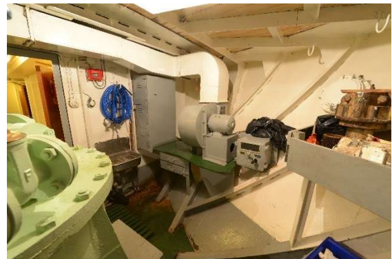
Figur 86 Fra rom for styremaskin
