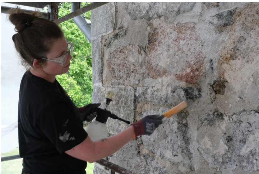
Under den første tørkinga oppstod det sintersjikt på fugene. Dei kan kjennast att som lysare parti med dårlegare sug. Ved hjelp av vass-sprøyte blir dei lett synlege før fjerning med stålborste. Foto: Morten Stige, Fabrica.
