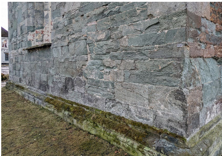
Betydeleg skadd kvadermurverk er sjeldan i Noreg. Her kjem skadane av brann og saltforvitring i mjuk grønskifer. Murverket har tidlegare vore pussa for å «skjule» skadane. Vår Frue kyrkje, Trondheim. Foto: Per Storemyr, Fabrica.
