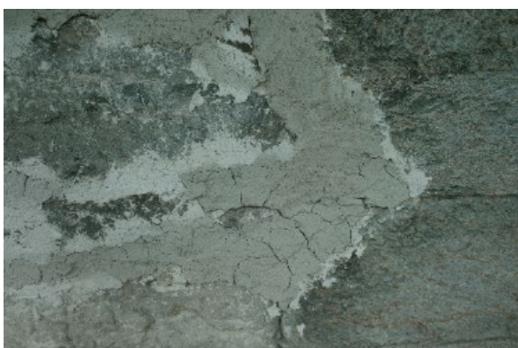
Kalkrik mørtel og rask tørk kan ofte gi svinnsprekkar som må komprimerast, særleg dersom mørtelen er blanda med mykje vatn. Hesby kyrkje. Foto: Morten Stige, Fabrica.
