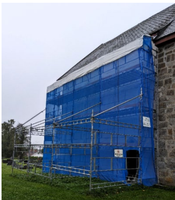
Stillas utan innfesting i murverk.
