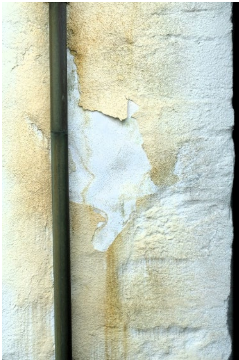
Ein rein kalkpuss som trong vedlikehald med kvitkalking blei i staden sett inn med ein organisk forsterka slemming. Det gav ei tett overflate trass i produsenten sine påstandar om diffusjonsopenheit. Over tid flaka slemminga av der det var mest fukt. Resten måtte fjernast mekanisk for å kome ned til den vedlikehaldsvenlege kalkpussen. Ogn kyrkje. Foto: Morten Stige, Fabrica.
