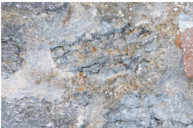
Forvitring av kalksteinsoverflata på Mariakyrkja på Gran etter 200 år utan puss. Forvittra stein skal normalt ikkje impregnerast, men ein kalkpuss vil stoppe nedbrytinga. Foto: Morten Stige, Fabrica.
