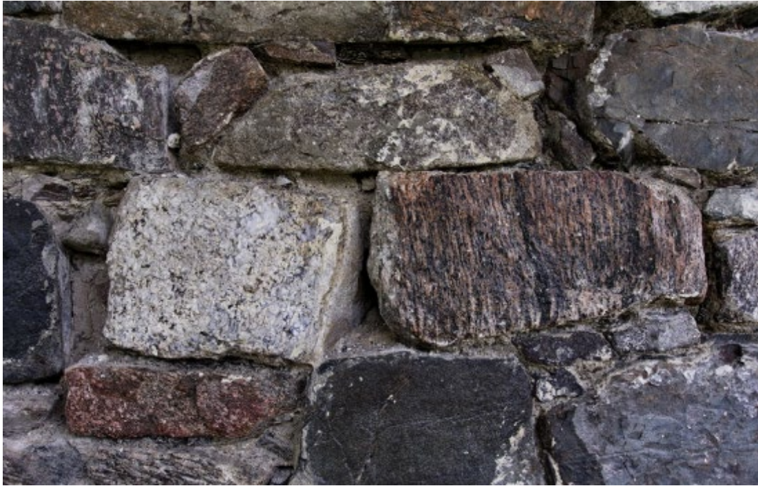
Biletet viser eit mellomaldersk murverk etter høgtrykksspyling som har fjerna all puss og mykje av fugene. Kjeldeverdien er sterkt redusert. Nesodden kyrkje. Foto: Leiv Bjerve.
